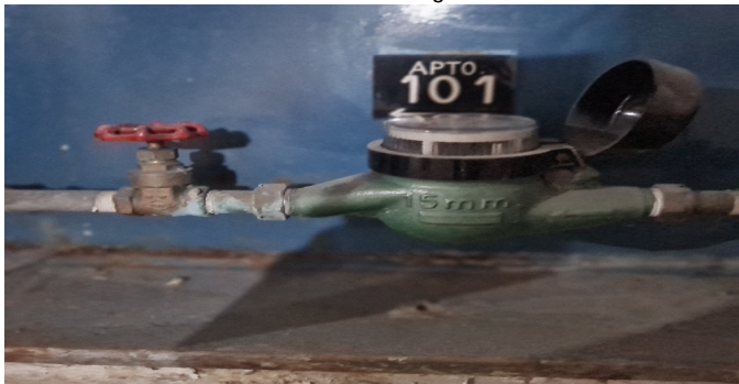
Contador de Agua
