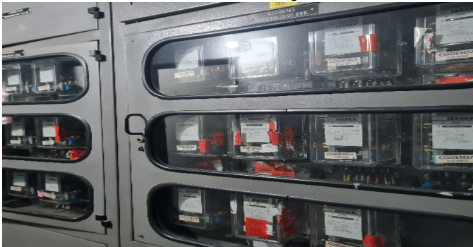
Contador de Energia
