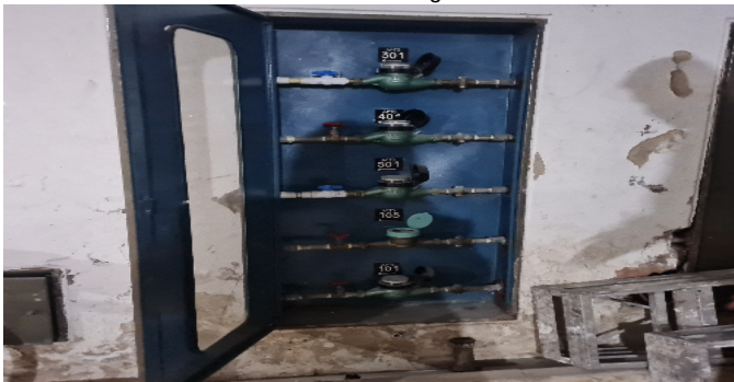
Contador de Agua
