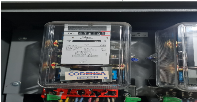
Contador de Energia
