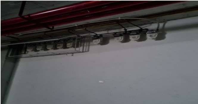
Contador de Gas
