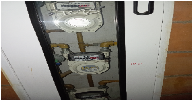
Contador de Gas
