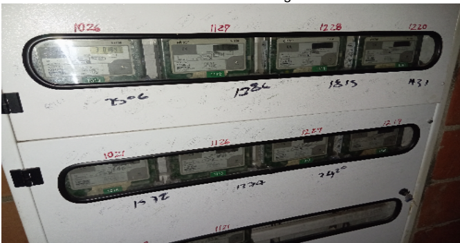
Contador de Energia
