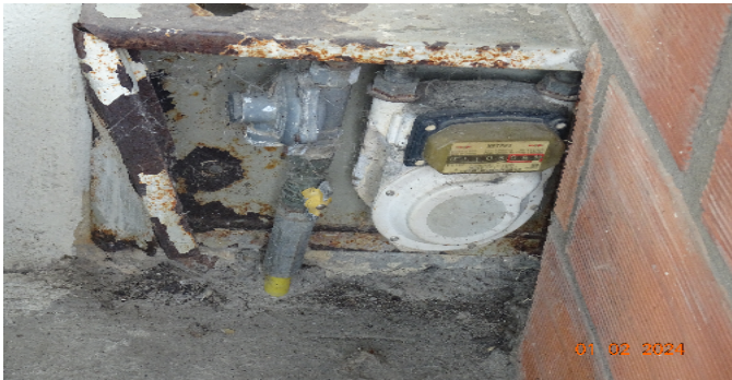
Contador de Gas
