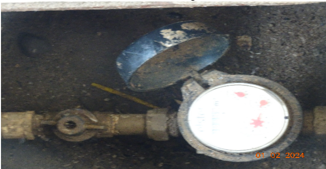
Contador de Agua
