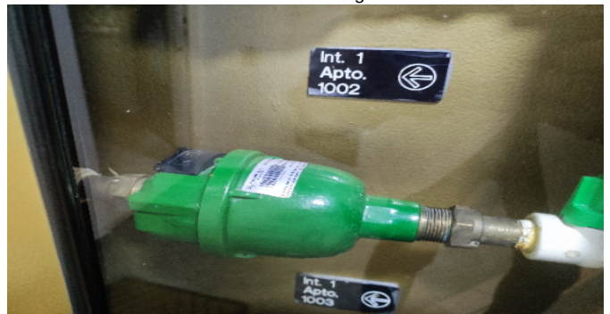
Contador de Agua
