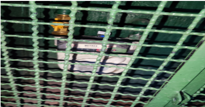
Contador de Gas
