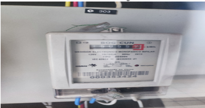
Contador de Energia
