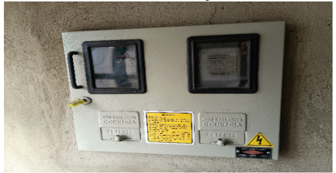
Contador de Energia
