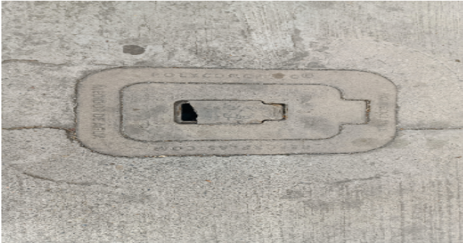
Contador de Agua
