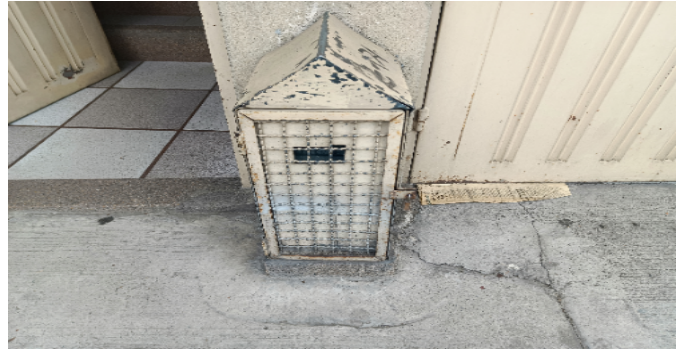
Contador de Gas
