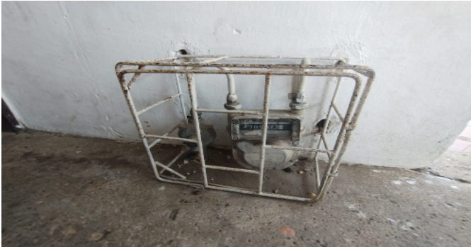
Contador de Gas
