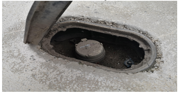
Contador de Agua
