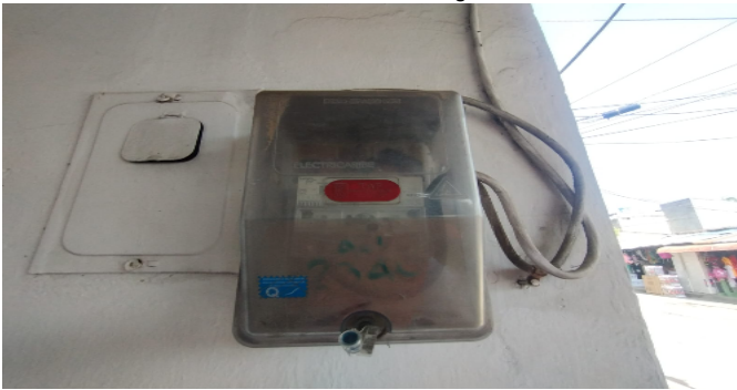
Contador de Energia
