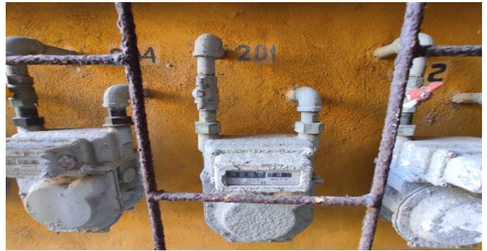
Contador de Gas
