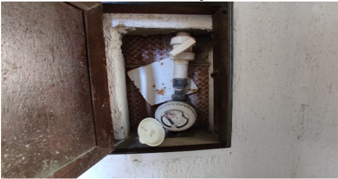
Contador de Agua
