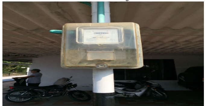
Contador de Energia
