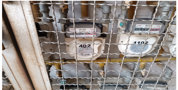
Contador de Gas
