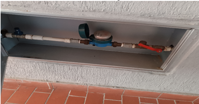
Contador de Agua
