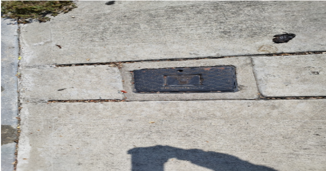
Contador de Agua
