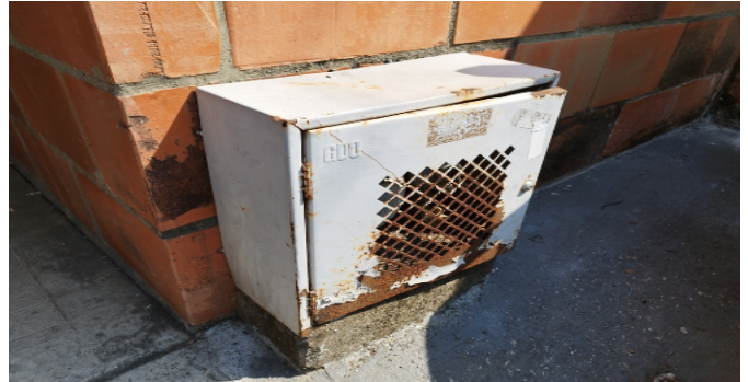
Contador de Gas
