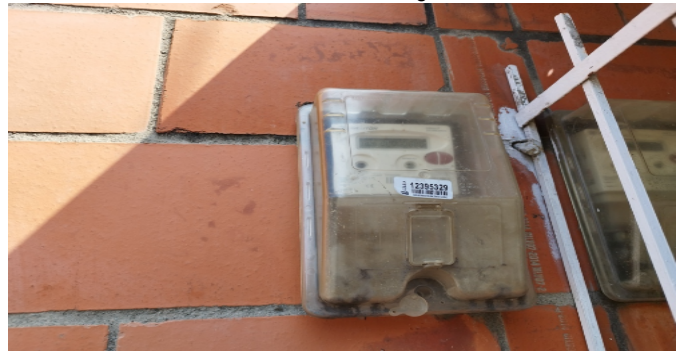
Contador de Energia
