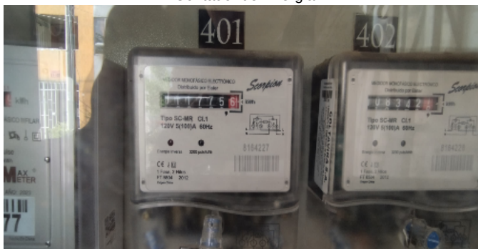
Contador de Energia
