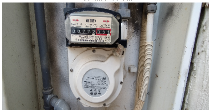
Contador de Gas
