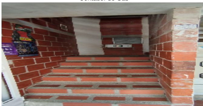
Contador de Gas
