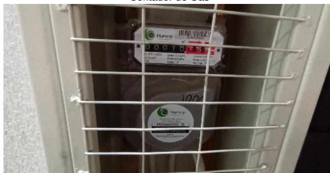
Contador de Gas
