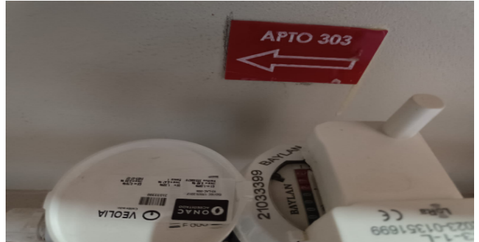
Contador de Agua
