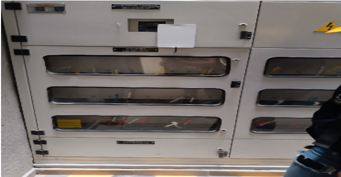
Contador de Energia
