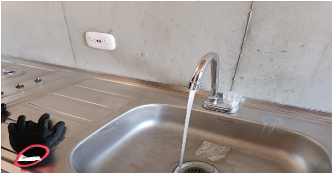
Contador de Agua
