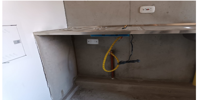
Contador de Gas
