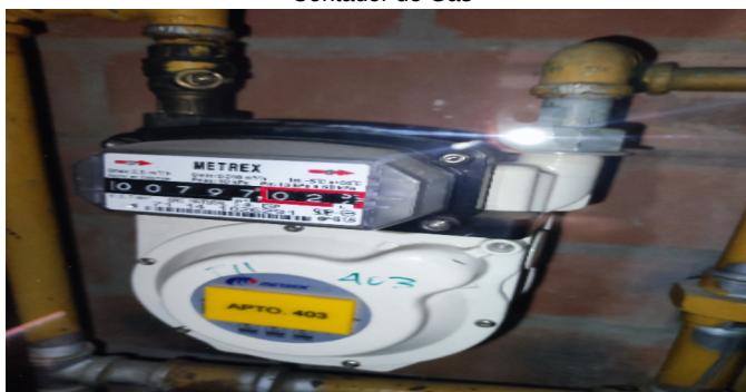
Contador de Gas
