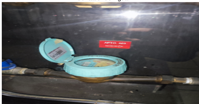
Contador de Agua
