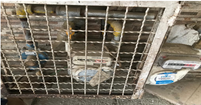
Contador de Gas
