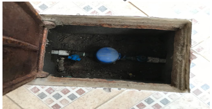
Contador de Agua
