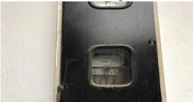
Contador de Energia
