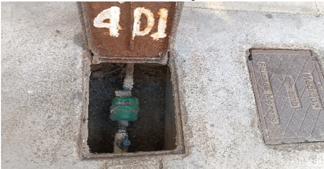
Contador de Agua
