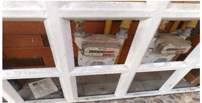
Contador de Gas
