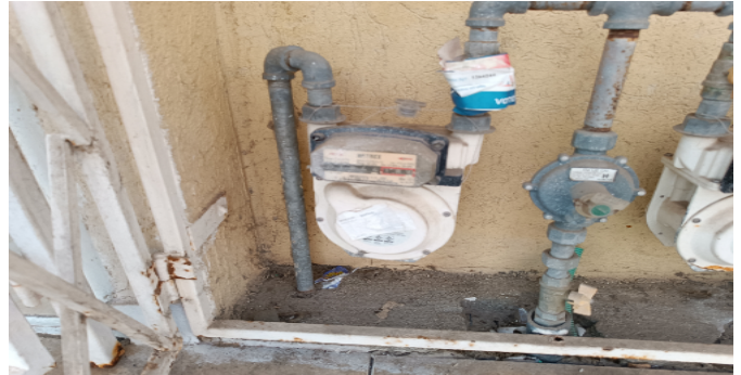
Contador de Gas
