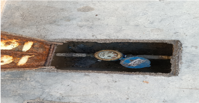
Contador de Agua
