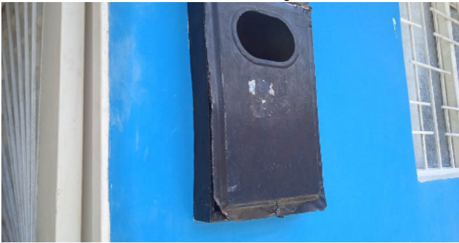
Contador de Energia
