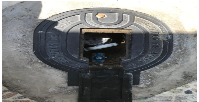
Contador de Agua
