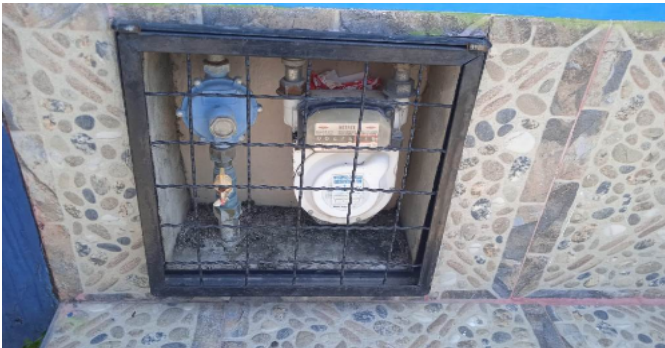
Contador de Gas
