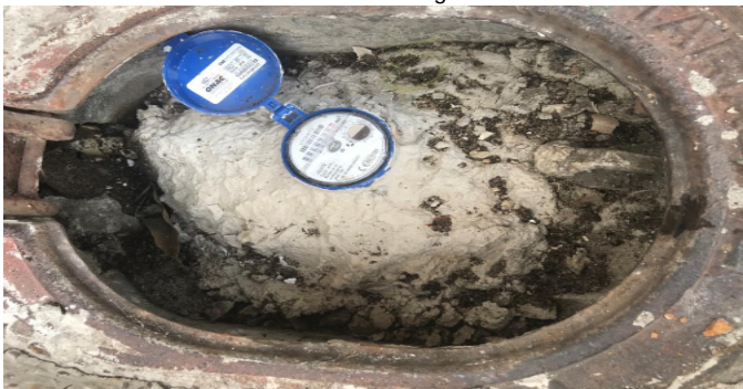
Contador de Agua
