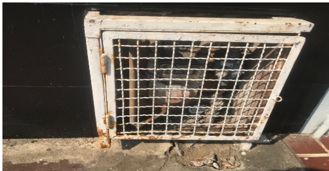
Contador de Gas
