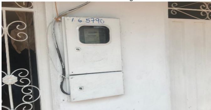
Contador de Energia
