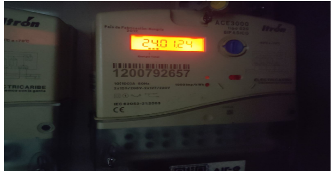
Contador de Energia
