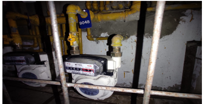
Contador de Gas
