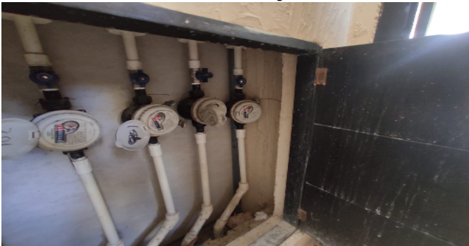
Contador de Agua
