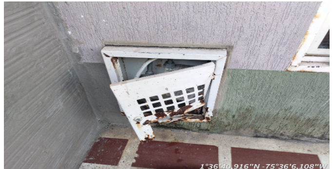
Contador de Gas
