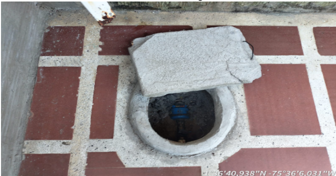
Contador de Agua
