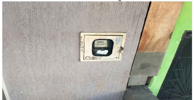
Contador de Energia
