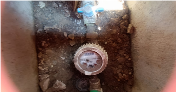
Contador de Agua
