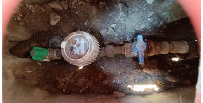
Contador de Agua
