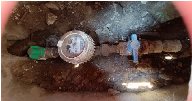
Contador de Agua
