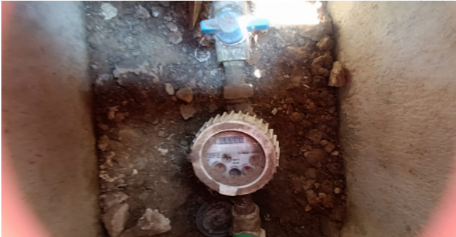
Contador de Agua
