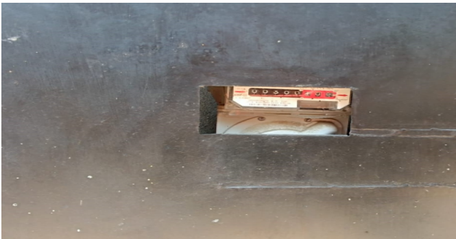
Contador de Gas
