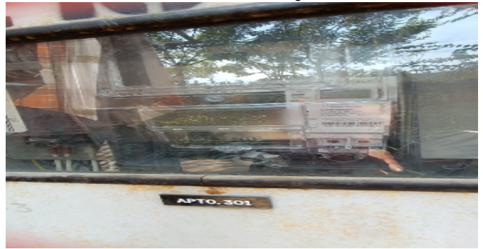
Contador de Energia
