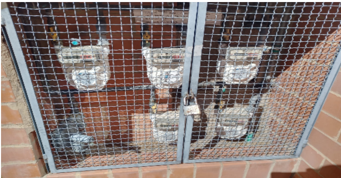
Contador de Gas
