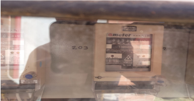
Contador de Energia
