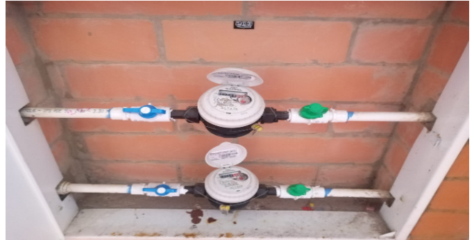
Contador de Agua
