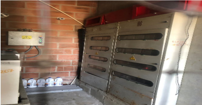
Contador de Energia
