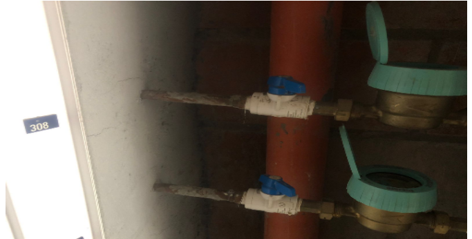
Contador de Agua
