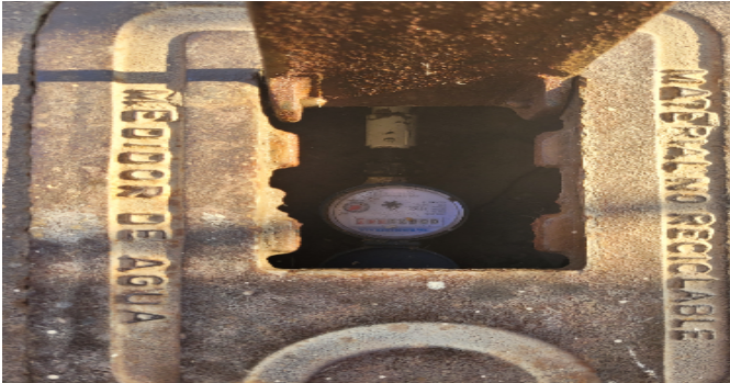
Contador de Agua
