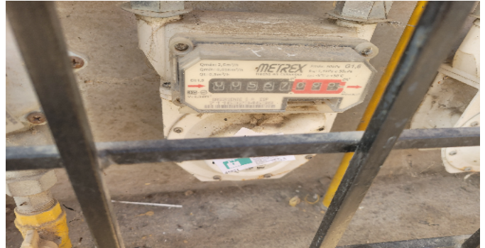
Contador de Gas
