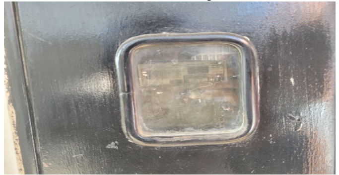
Contador de Energia
