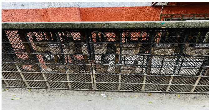
Contador de Gas
