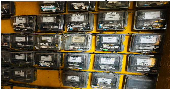
Contador de Energía
