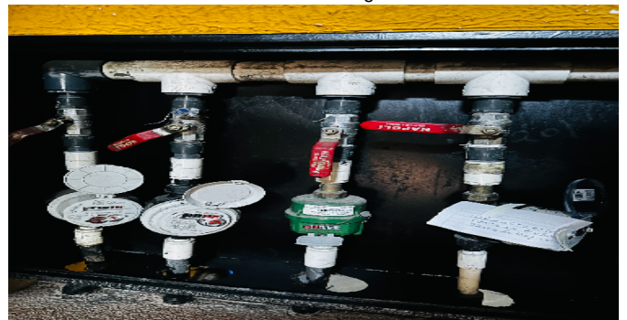
Contador de Agua
