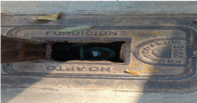
Contador de Agua
