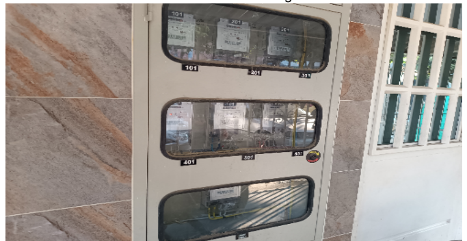
Contador de Energia
