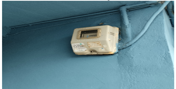
Contador de Energia
