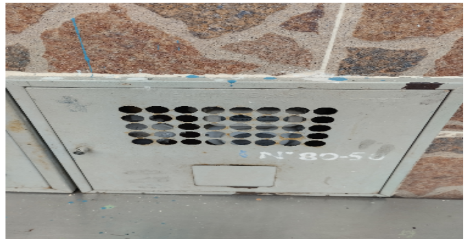
Contador de Gas
