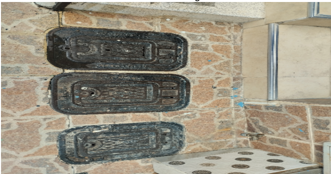
Contador de Agua
