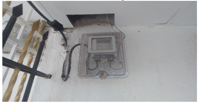
Contador de Energia
