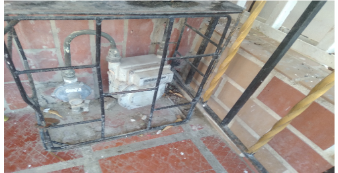
Contador de Gas
