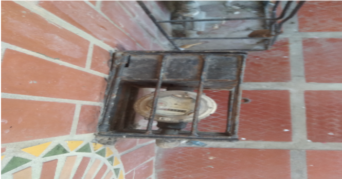
Contador de Agua
