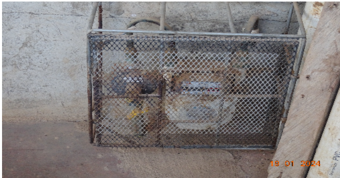
Contador de Gas
