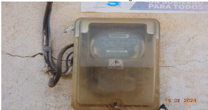
Contador de Energia
