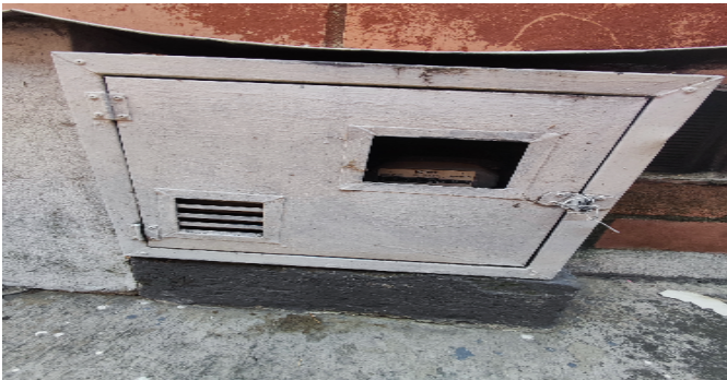
Contador de Gas
