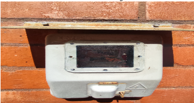
Contador de Energia
