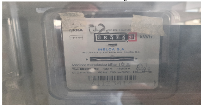
Contador de Energía
