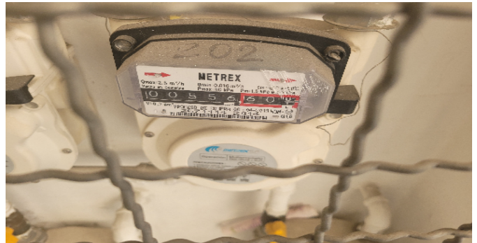
Contador de Gas
