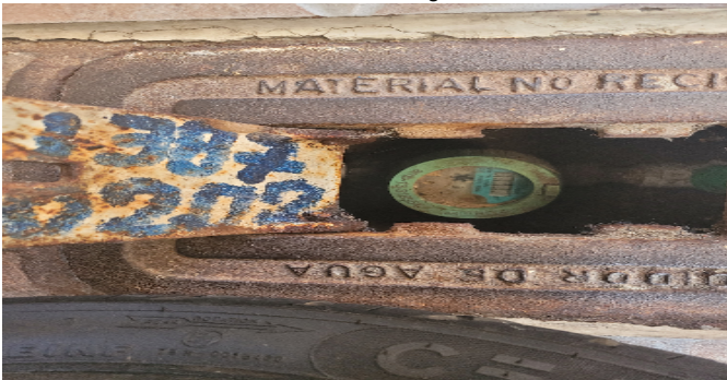
Contador de Agua
