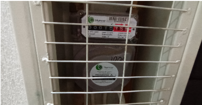
Contador de Gas
