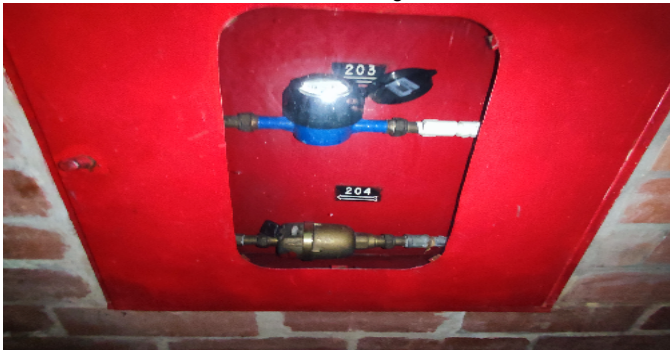
Contador de Agua
