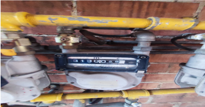
Contador de Gas
