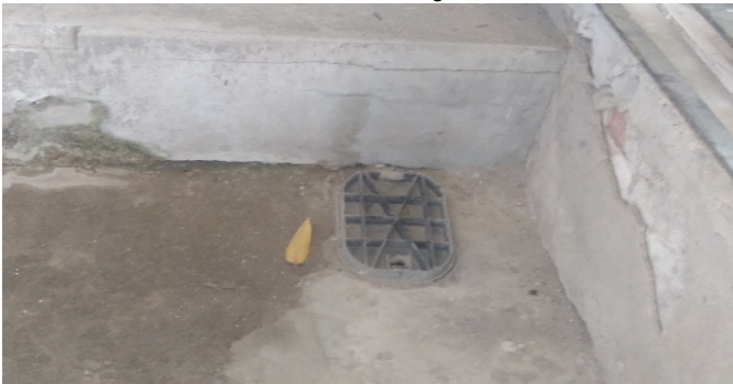
Contador de Agua
