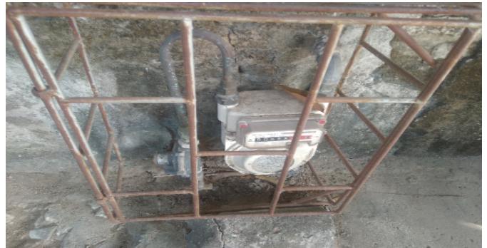
Contador de Gas
