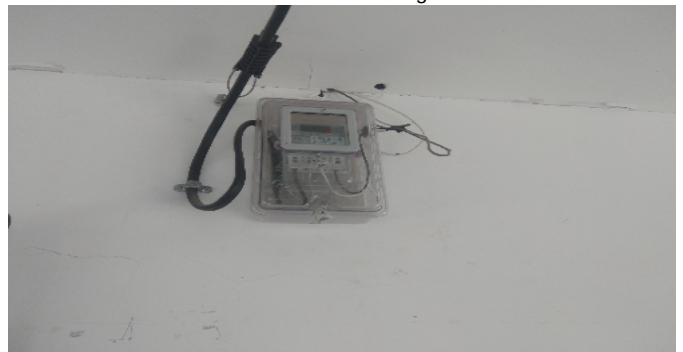
Contador de Energia
