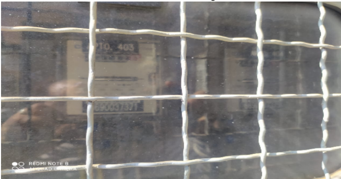
Contador de Energia
