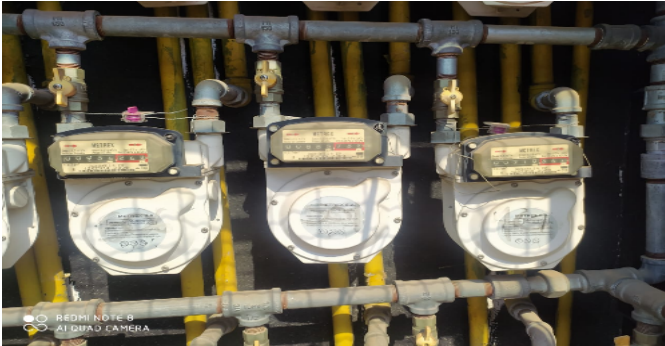
Contador de Gas
