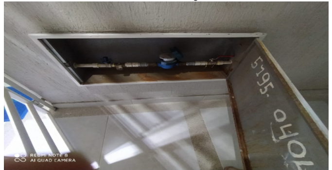
Contador de Agua
