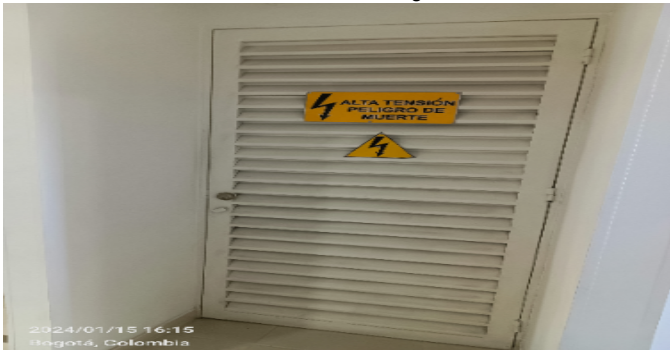
Contador de Energia
