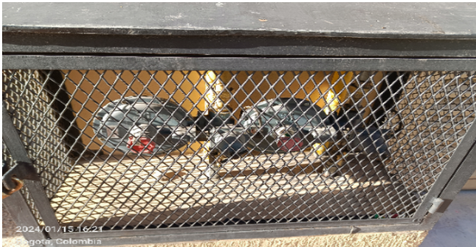
Contador de Gas
