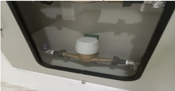
Contador de Agua
