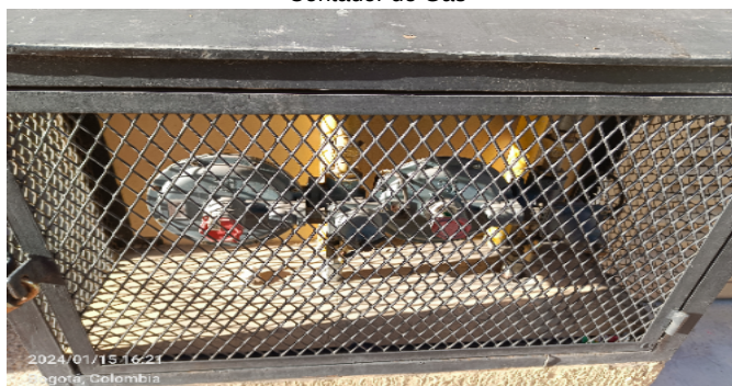
Contador de Gas
