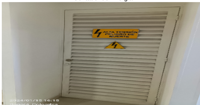
Contador de Energia
