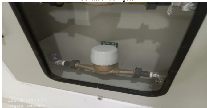
Contador de Agua
