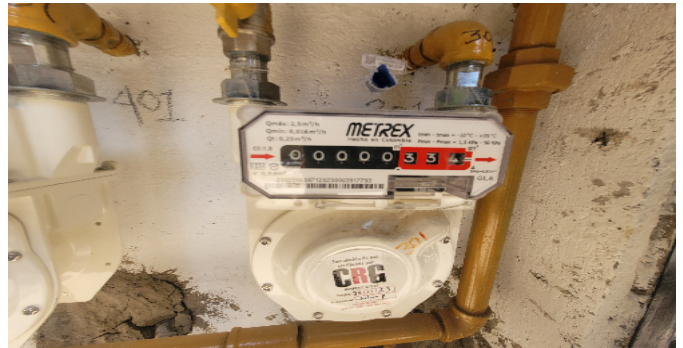
Contador de Gas
