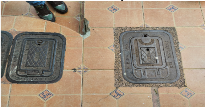
Contador de Agua
