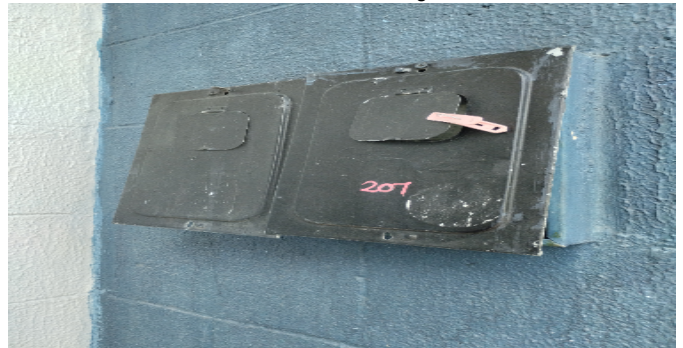
Contador de Energia
