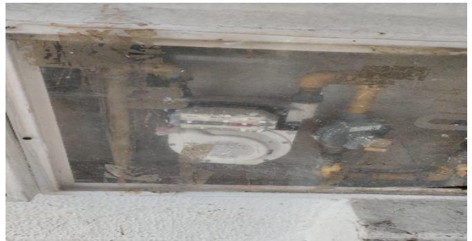
Contador de Gas
