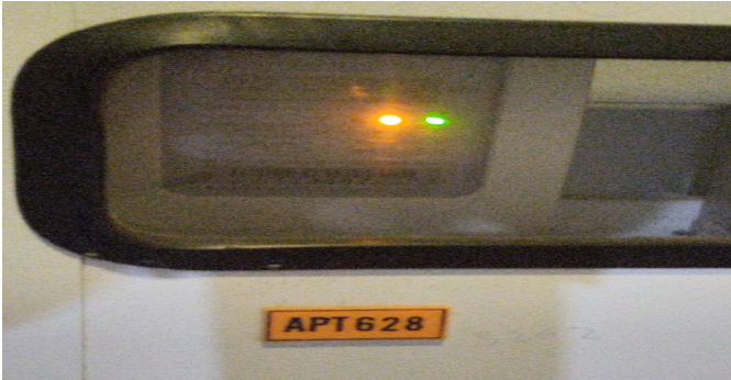
Contador de Energia
