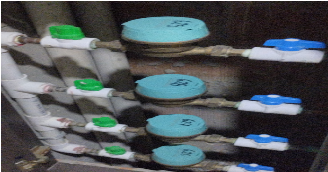
Contador de Agua
