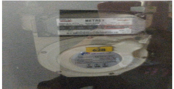
Contador de Gas
