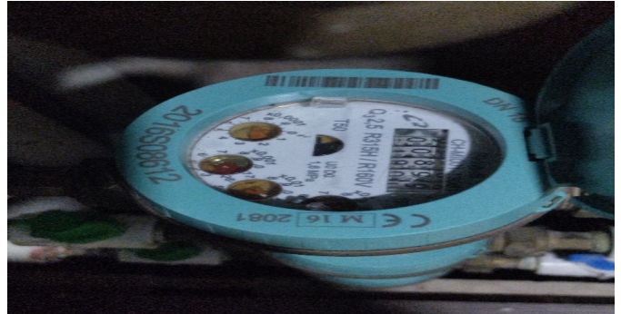
Contador de Agua
