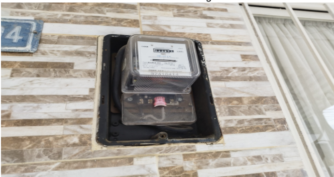
Contador de Energia
