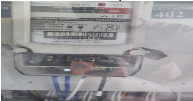
Contador de Energia
