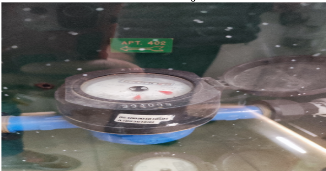
Contador de Agua
