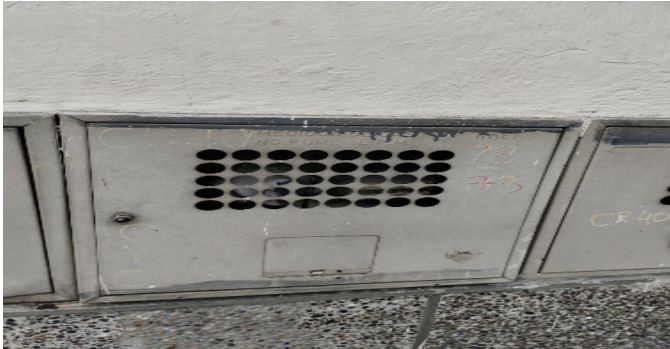
Contador de Gas
