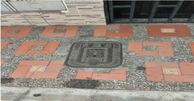
Contador de Agua
