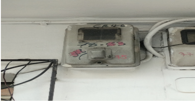
Contador de Energia
