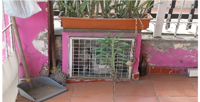
Contador de Gas
