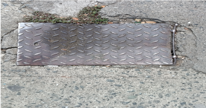
Contador de Agua
