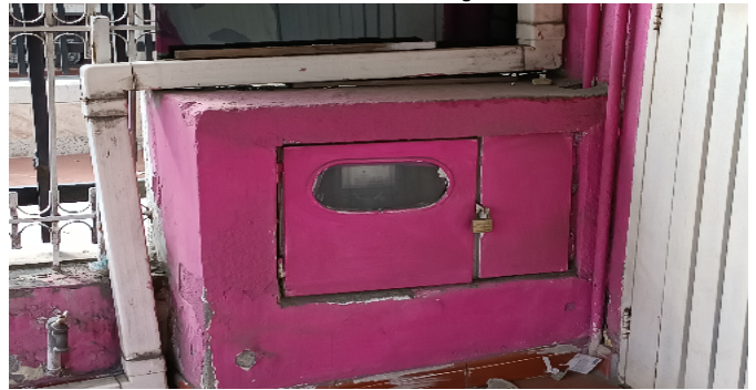
Contador de Energia
