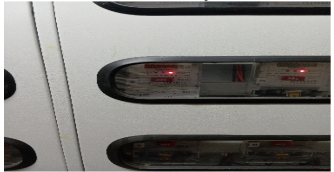
Contador de Energia
