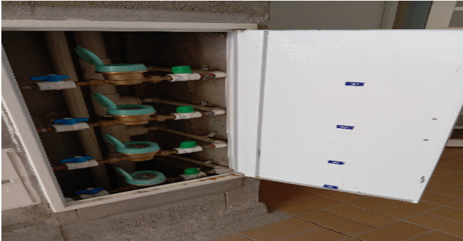
Contador de Agua
