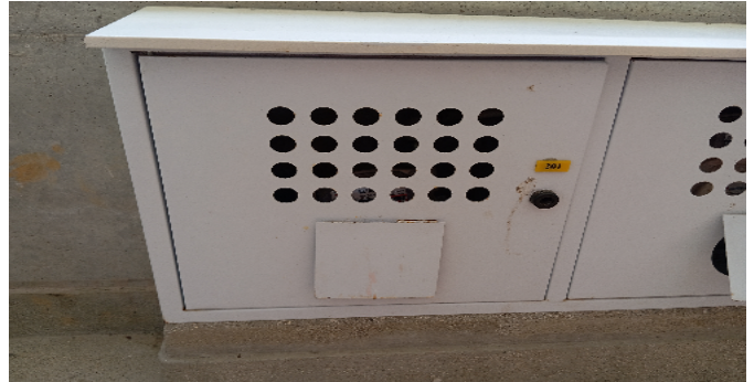
Contador de Gas
