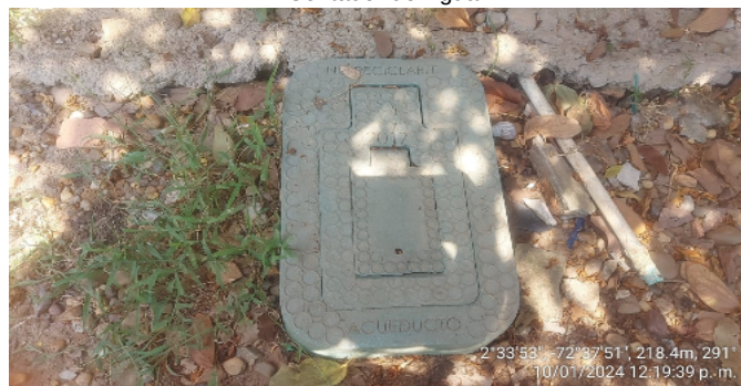
Contador de Agua
