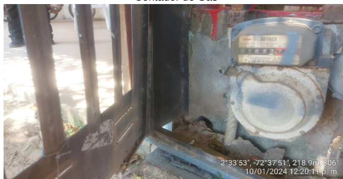
Contador de Gas
