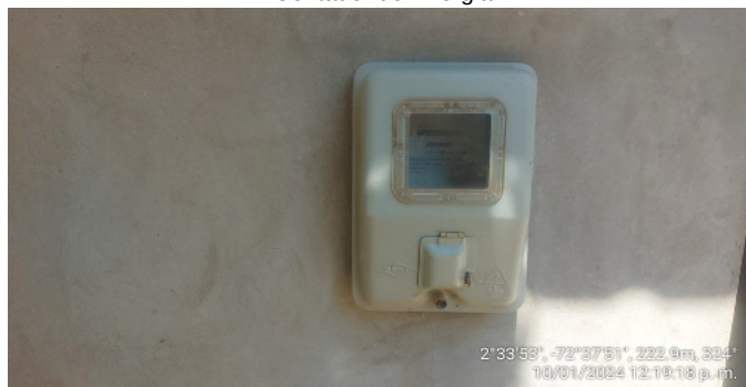
Contador de Energia
