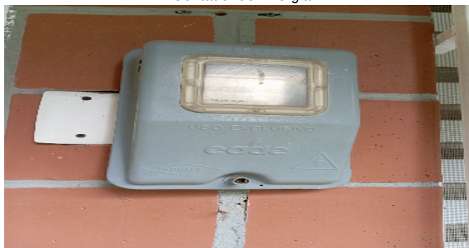
Contador de Energia
