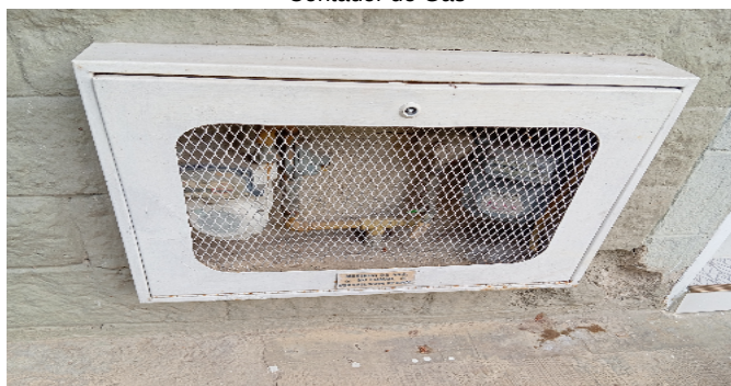
Contador de Gas
