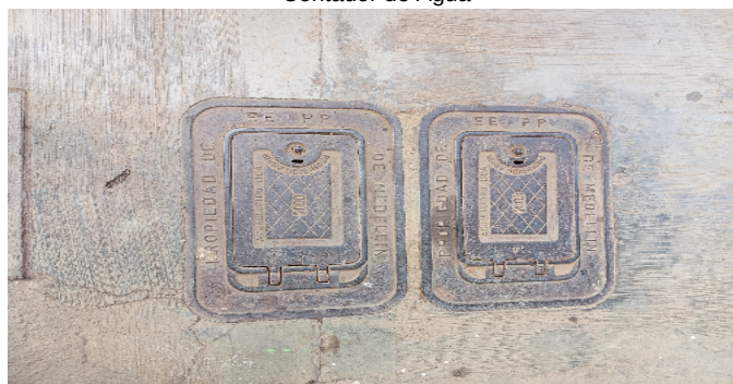
Contador de Agua
