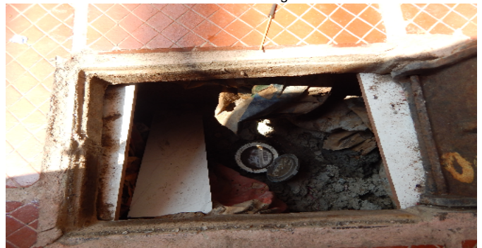
Contador de Agua
