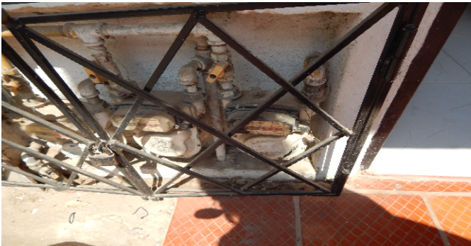
Contador de Gas
