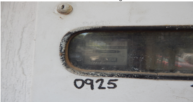
Contador de Energia
